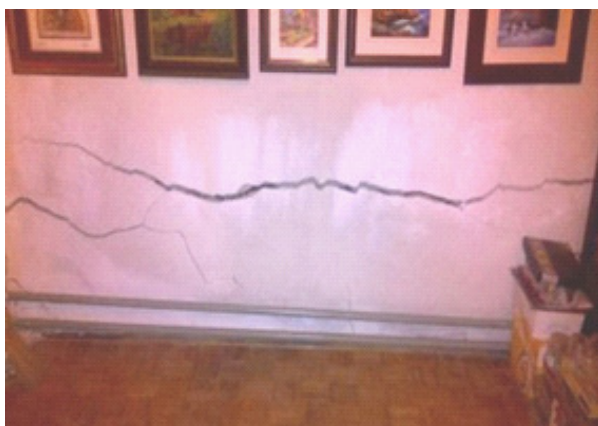
Slika 14. Velika oštećenja zidova na obiteljskoj kući u ulici Sokolovac [7]
