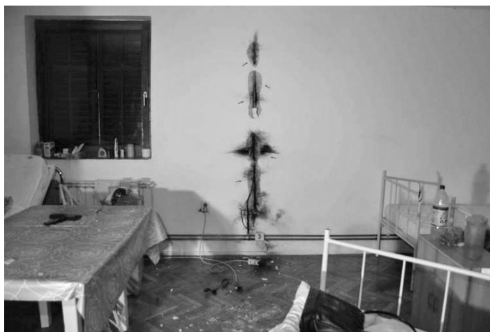
Slika 7: Tragovi udara groma na električnoj instalaciji u objektu (Papić, lit. 6.)
