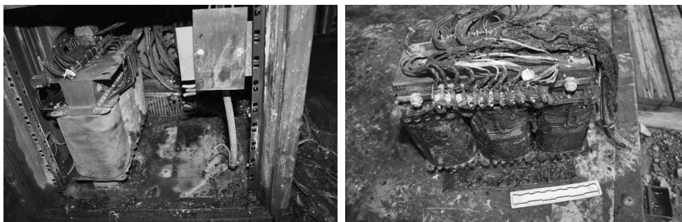
Slike 5 i 6: Tragovi požara u unutrašnjosti upravljačke jedinice i izuzeti transformator (Papić, lit. 6.)
