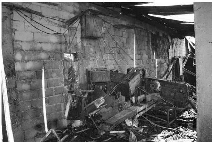
Slika 2: Požar u pogonu drvene industrije (električna instalacija) (Papić, lit. 8. i lit. 10.)
