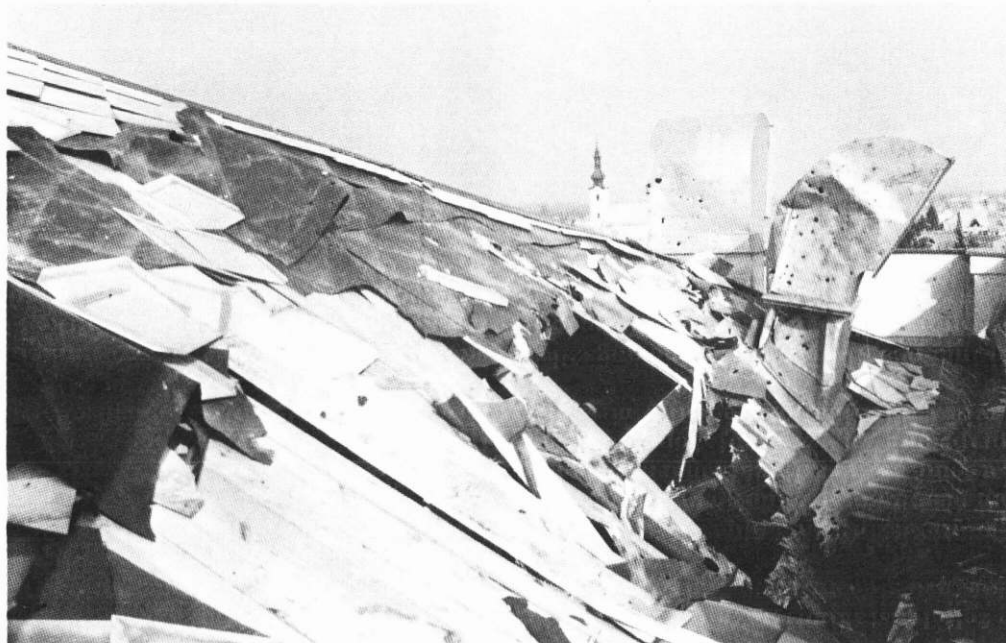
SLIKA 3. Oštećenje krovne konstrukcije topovskom granatom južnog dijela zgrade FIGURE 3. The damage of the roof of the southern part of the building by a canon grenade
