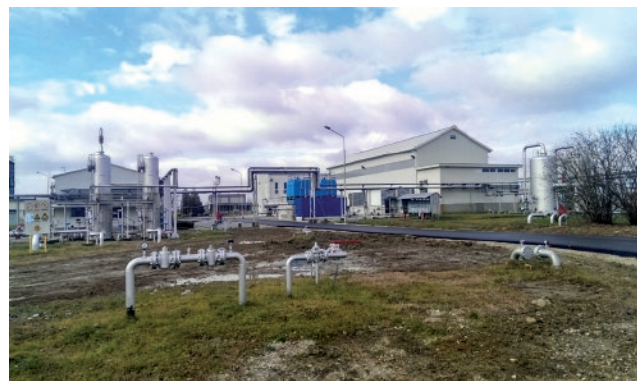
Slika 5. Kompresorska i pumpna stanica sa sustavom za ukapljivanje ugljičnog dioksida u Ivanić-Gradu
