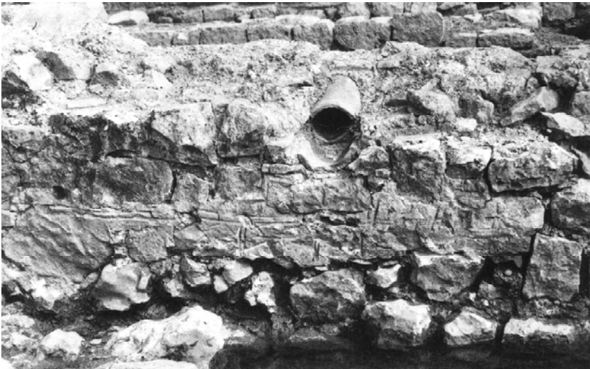
Sl. 16. Detalj s vanjskog zida nartekse u pročelju crkve, vidi se kanal za odvod vode i dio ukrasne žbuke (1993.). Fig. 16. Détail du mur extérieur du narthex sur la façade; on remarque le canal d'évacuation de l'eau et une partie du mortier décoratif (1993).
