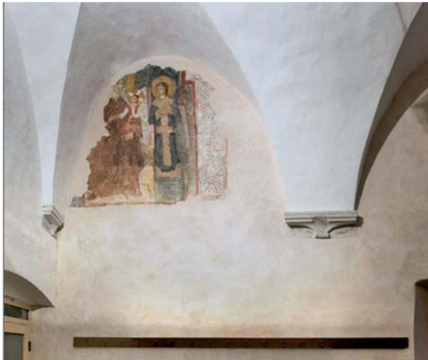
23. Dubrovnik, Franjevački samostan Male braće. Stanje nakon radova, primjer reintegracije žbukanog sloja. (Fotografirala: Katarina Gavrilica) / Dubrovnik, Franciscan Monastery. Post reconstruction state, example for the integration of the plastered layer. (Photo: Katarina Gavrilica)
