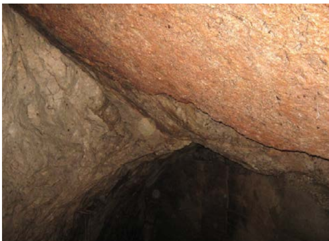
Slika 5.18. Rasjed 290/30 u stropu ulaznog dijela kaverne duž kojeg se pruža kanal (foto: D. Lacković).
