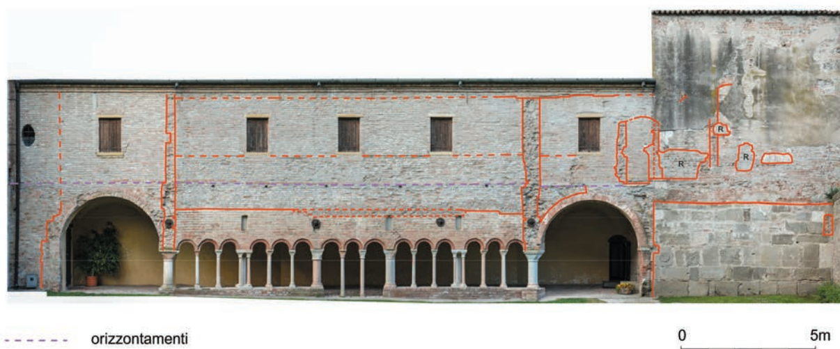
Fig. 21. Carceri, Santa Maria, perimetrale sud della casa torre e portico del chiostro addossato alla chiesa, probabilmente riferibile ai lavori conclusi con la riconsacrazione del 1189.
