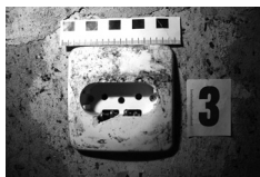
Slika 5. Trofazna zidna utičnica na koju je bio priključen kabel
