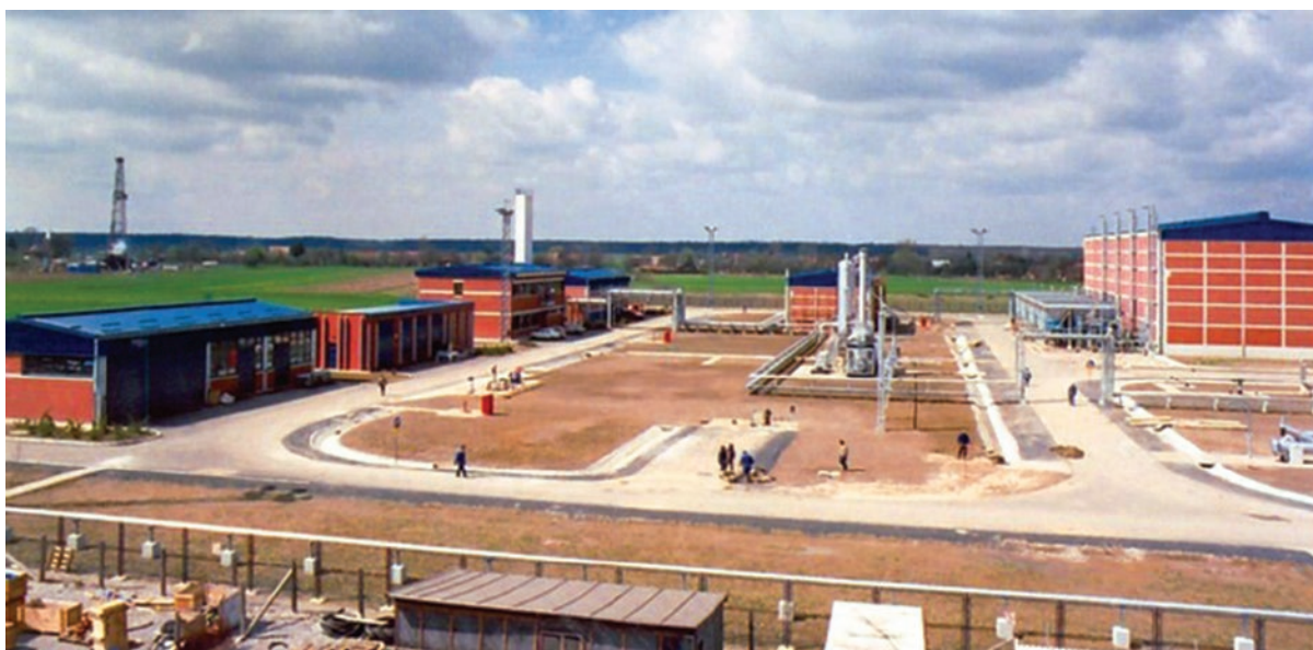
Slika 1. Gradnja Podzemnog skladišta plina Okoli (Izvor: Novak Zoroe S. Hrvatski naftaši, HUNIG; 2013.)
