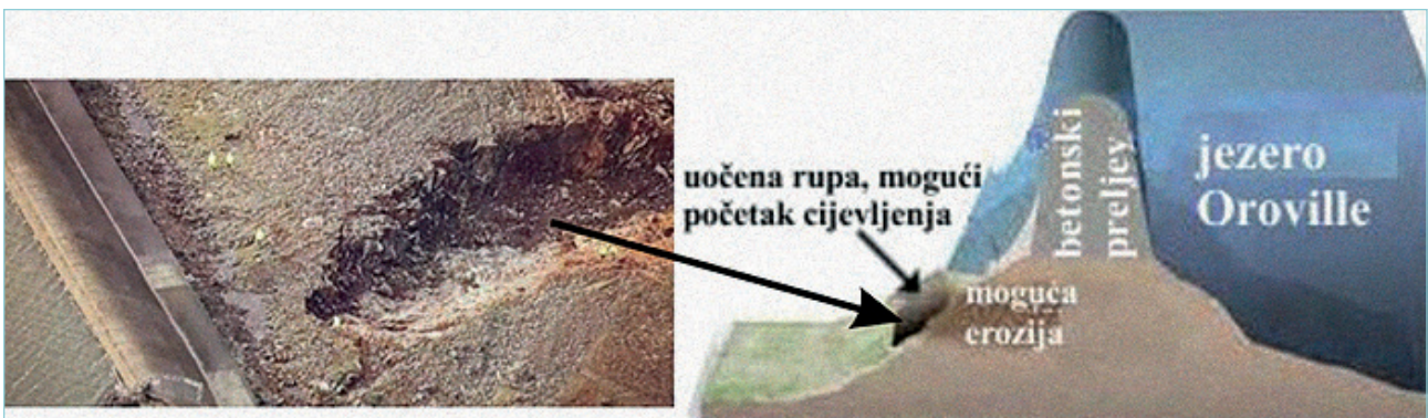
Slika 10: Udubina sa slike 9 i skica interventnog preljeva s udubinom u tlu ispod zida
