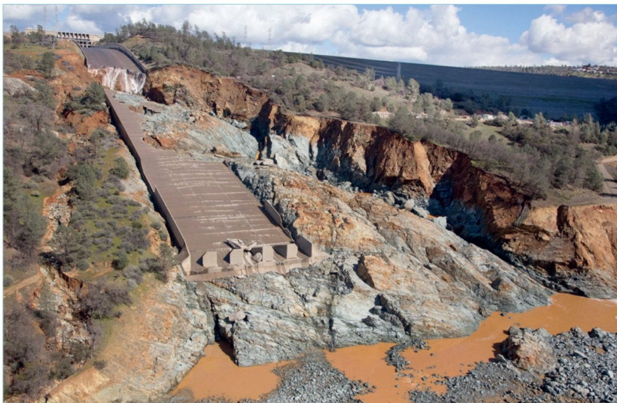
Slika 12: Posljedice prelijevanja na već oštećenom bočnom preljevu nakon 11. 02. 2017. (izvor: California Department of Water Resources; Dale Kolke, 27. 02. 2017.)
