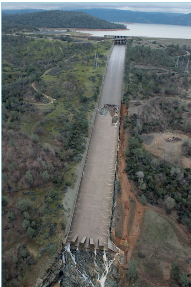
Slika 4: Bočni preljev brane Oroville, s razbijačima energije, nakon oštećenja 7. veljače 2017. godine (California Department of Water Resources; Kelly M. Grow, 07. 02. 2017.)
