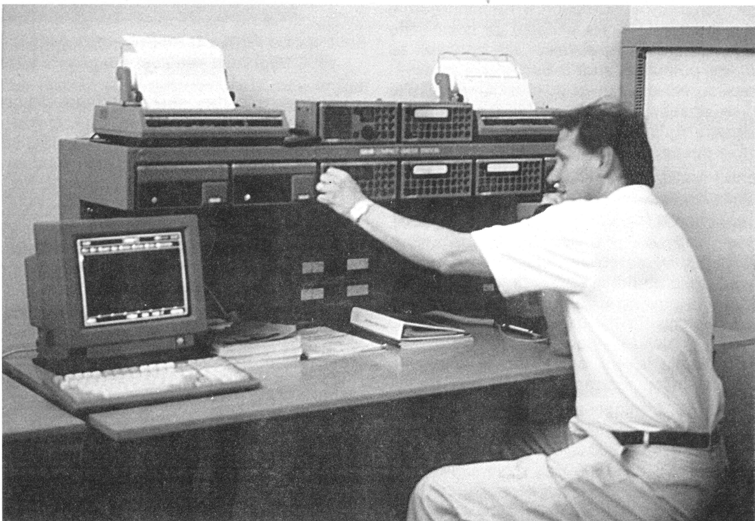
Slika 2. Radio oprema smještena u Komunikacijskom kabinetu Figure 2. Radio equipment placed in the communication room
