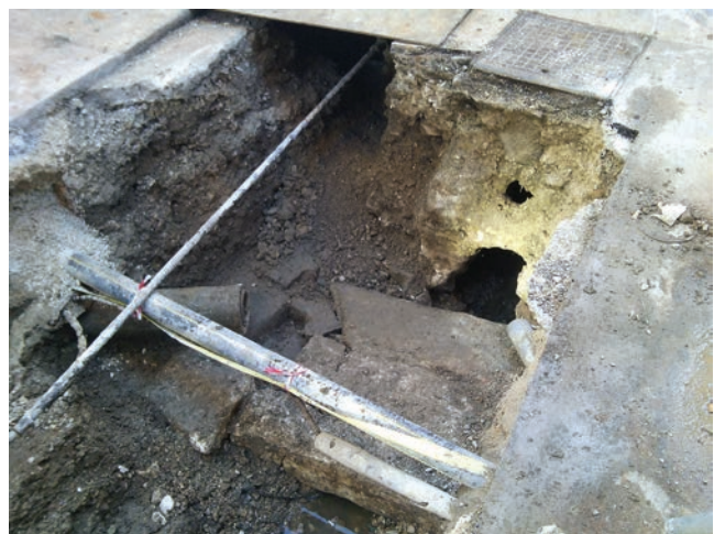
Sl. 19 Glavna kanalizacija na području De Villeovog uspona i Ulice Sergijevaca (foto: R. Zlatunić). Fig. 19 Main sewerage network in the area of the De Villeov uspon and Sergijevaca Streets (photo by: R. Zlatunić).
