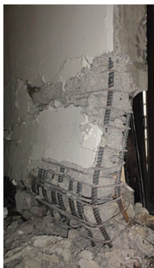
Slika 2. Oštećenje zida-potres u Novom Zelandu
