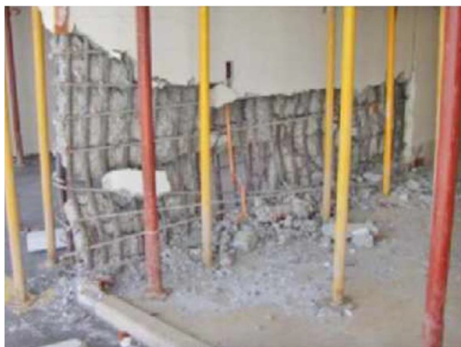
Slika 1. Oštećenje zida-potres u Chileu
