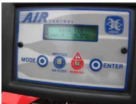
Slika 13. Elektronski nadzor rada sustava za zaštitu u kabini
