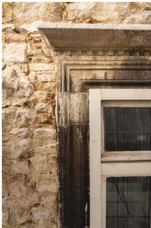
11. Detalj prozora prvog kata s vidljivom opečnom građom uz kameni okvir koja sugerira naknadnu ugradnju, kao i naknadno ubačeni fragment doprozornika drukčije obrade površine
