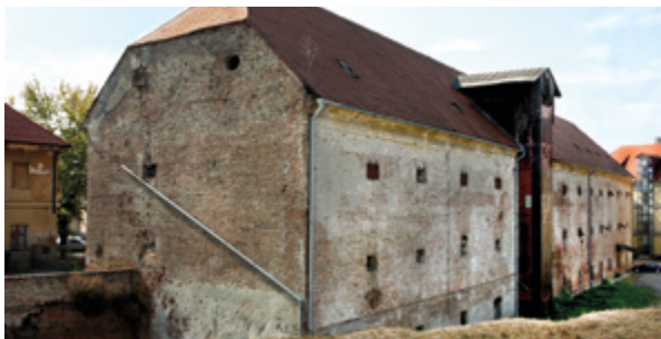
Sl. 1. Pogled na sjeverno i istočno dvorišno pročelje zgrade (fototeka Konzervatorskog odjela u Osijeku, snimila A. Mutnjaković)
