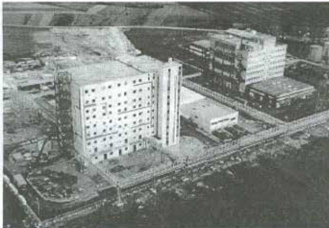
Slika 3. Početak izgradnje objekta višenamjenske sinteze (VNS – azitromicin) u Savskom Marofu, (1994), završen 1998 (prilagođeno prema Mutak 1996)
