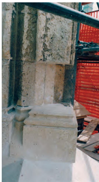
Obnova južnog kontrafora originalnim kamenom tipa bizek – kamen je dobiven piljenjem većih blokova demontiranih na sjevernom tornju (klesarski rad radionice Kamen Pučišća d.o.o.)
