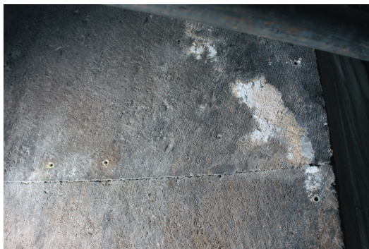
Iscvjetavanje soli na kamenoj površini istočnog dijela niše
