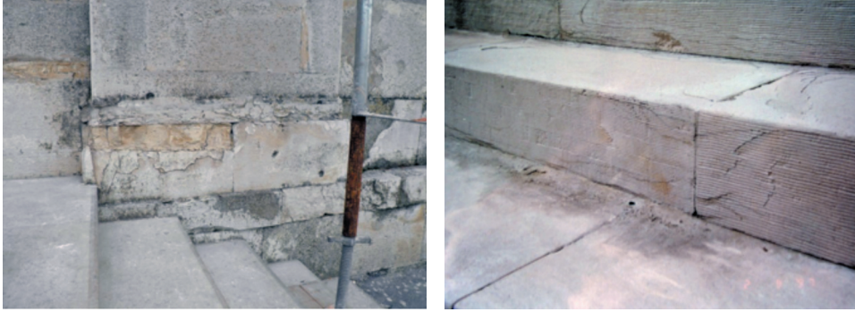
Slika 2. i 3. Oštećenja uslijed cementa
