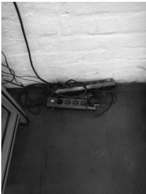
Slika 1. Neuredne instalacije na podu radnog prostora
