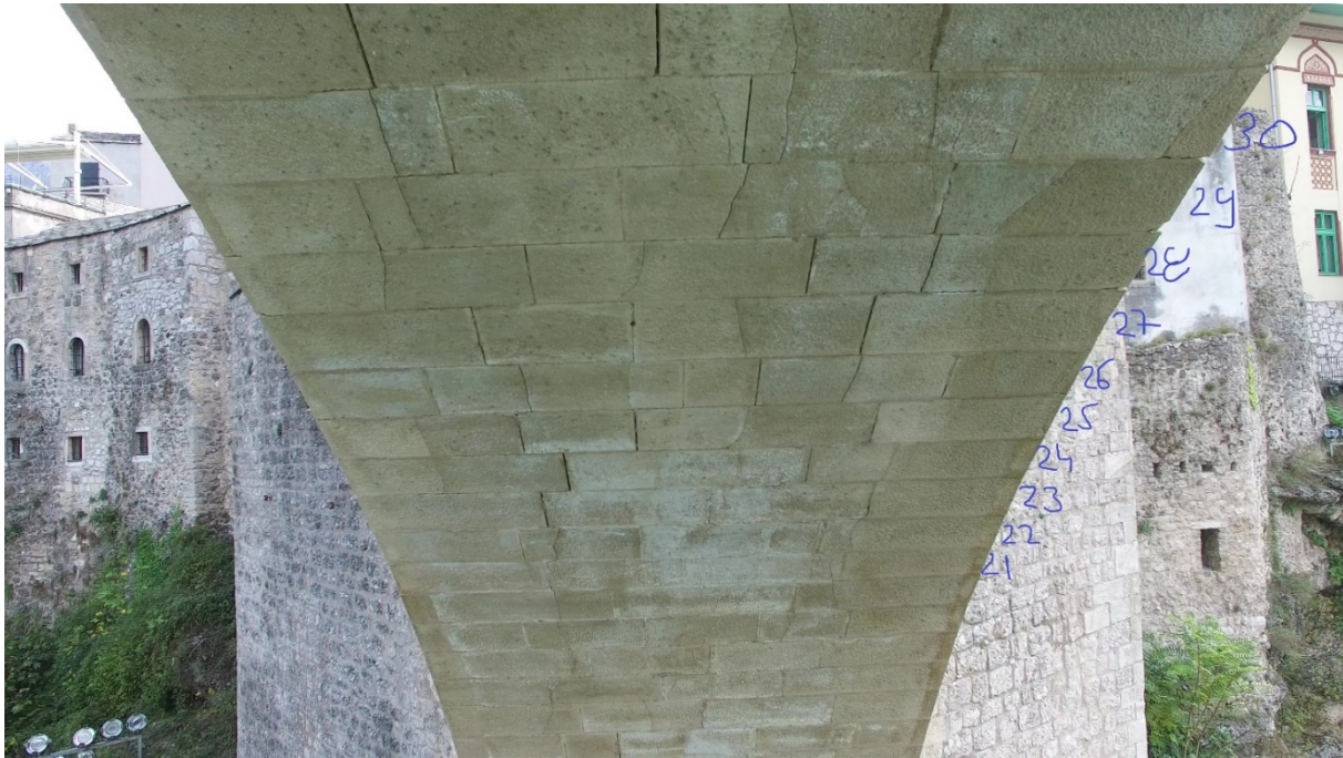
Slika 13. Naprsline na intradosu mosta istočna strana, 2018 godine
