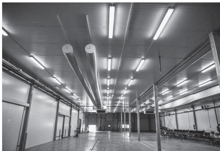
Slika 1: Prazna komora ULO hladnjače
