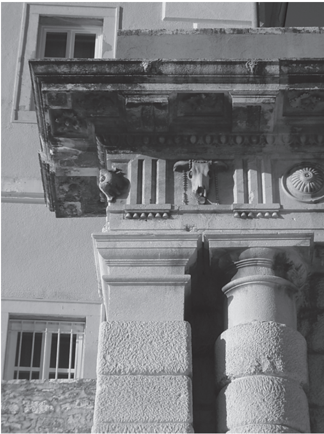
Trabeacija i kapiteli na lijevome rubu vrata (foto: P. Vežić) Trabeation and capitals on the left edge of the gate
