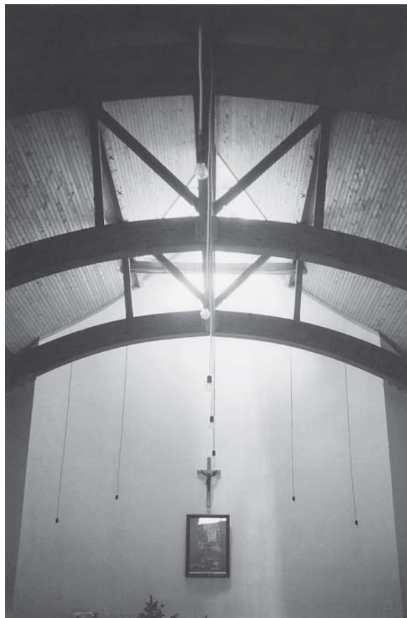
Z. Hanžek, crkva u Hrgovima Donjim, detalj krovne konstrukcije Z. Hanžek, church in Hrgovi Donji, roof construction detail
