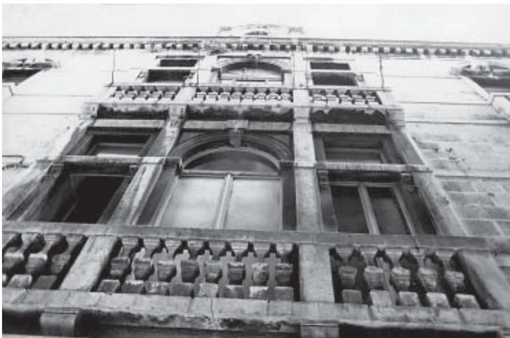
Palača Cindro, Krešimirova 3, trifore glavnog pročelja (foto: K. Horvat-Levaj) Cindro Palace, Krešimirova 3, triforia of main façade
