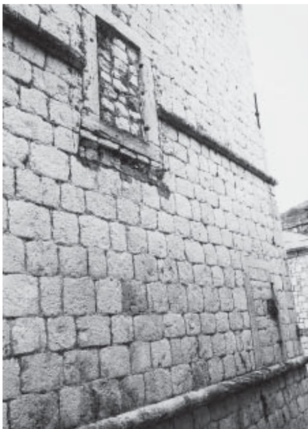
Perastijeva kula, zapadno pročelje, zazidana vrata – donja s tragovima uporišta pokretnog mosta i gornja s tragovima zidanog mosta (foto: K. Horvat-Levaj)
