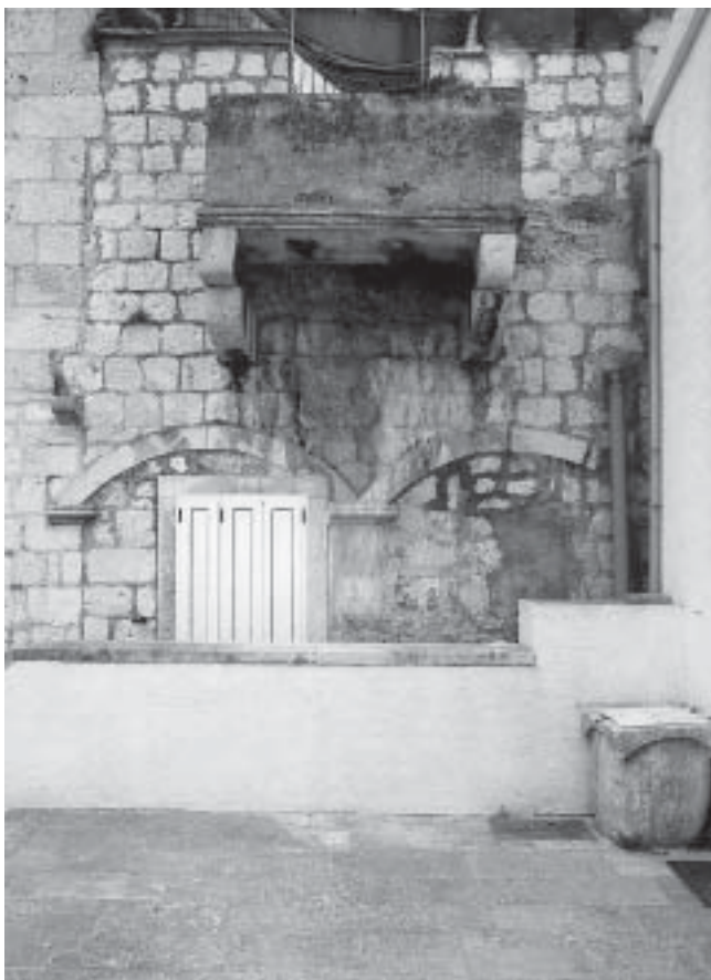
Perastijeva kuća, zapadno pročelje s ložom i balkonom terase (foto: K. Horvat-Levaj)
