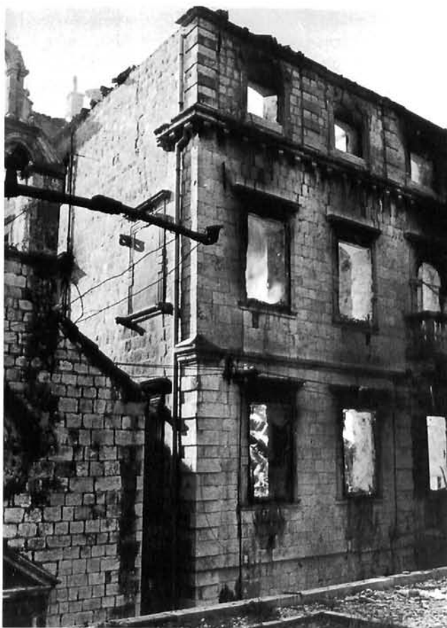
Široka ulica 5, Od puča 17 – palača Trifoni-Đorđić, požar 6. prosinca 1991. (foto: M. Kerner)
