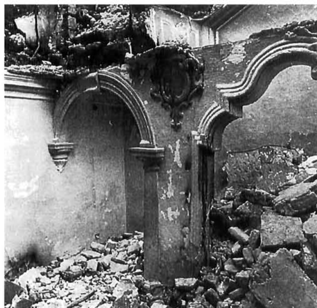
Pracatova 6 - palača Sorkočević, predvorje u prizemlju nakon ratne destrukcije (foto M. Mojaš)
