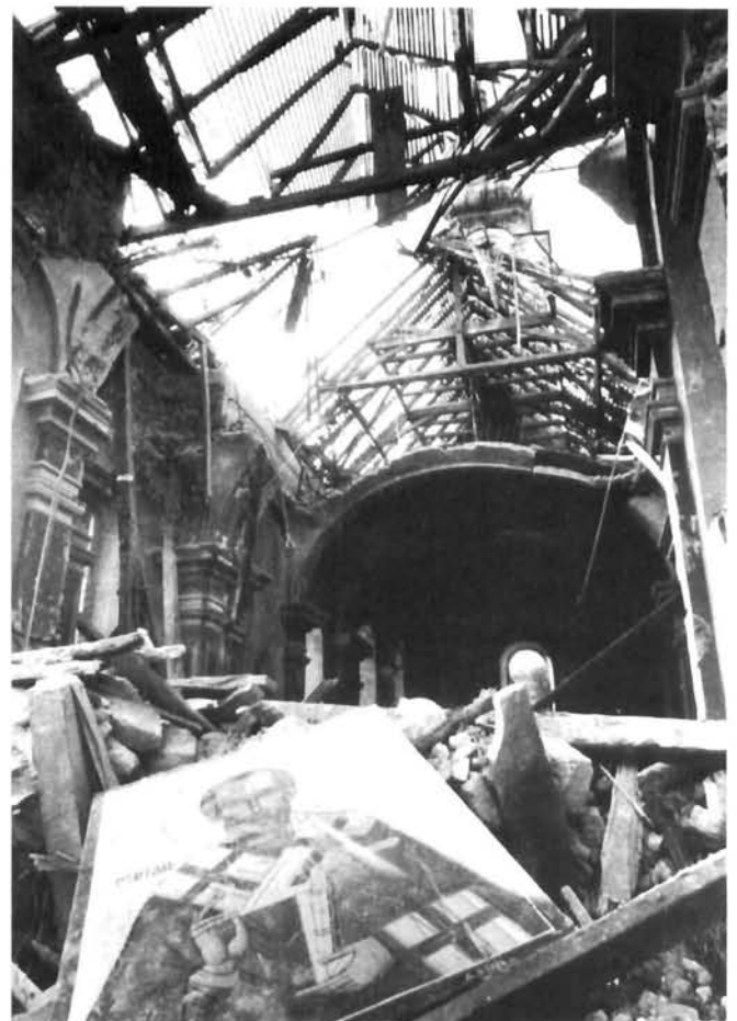
Karlovac, unutrašnjost razorene Pravoslavne crkve sv. Nikole, siječanj 1992. (dokumentacija Zavoda za zaštitu spomenika kulture Karlovac)
