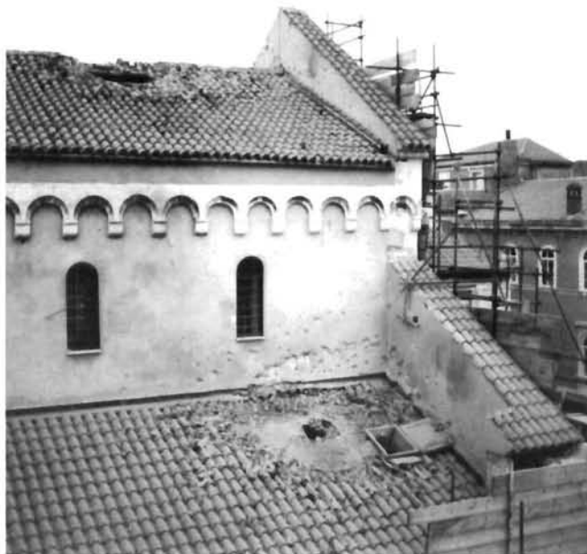
Zadar, Katedrala sv. Stošije, oštećenja na krovu (foto: P. Vežić) Zadar, St. Anastasia Cathedral, damage on the roof (photo: P. Vežić)
