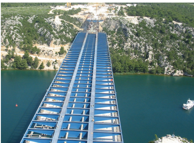
Slike (odozgor prema dolje): Početak izgradnje luka; Zatege kod izgradnje mosta; Čelična konstrukcija na mostu
