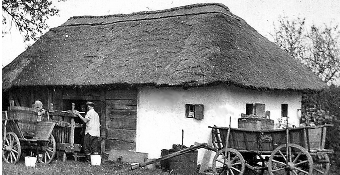
Sl.7. Klijet snimljena 1974. na lokalitetu Belevine južno od Đurđevca (gore), ista klijet snimljena 1998. (dolje) – usporedbom dvije fotografije može se predočiti koliko brzo propada konstrukcija ukoliko se krov načet atmosferilijama ne zamijeni novim (foto: V. Zebec).
