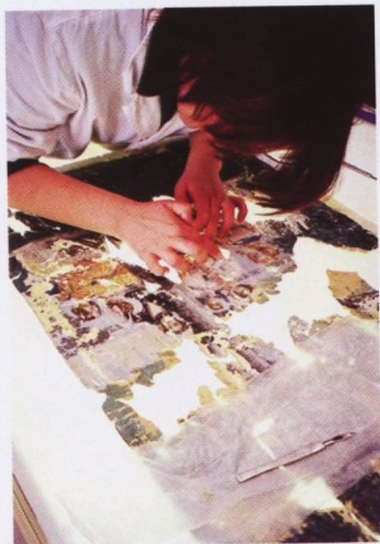
Detalj papirnatih tapeta „Francuski vrtovi“ iz palače Katić u Dubrovniku u tijeku radova na sanaciji oštećenja.
