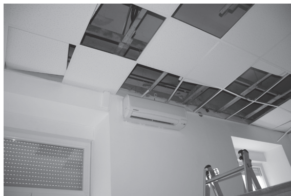
Slika 4. Mjesto oštećenja električne instalacije kod postavljanja konstrukcije spuštenog stropa
