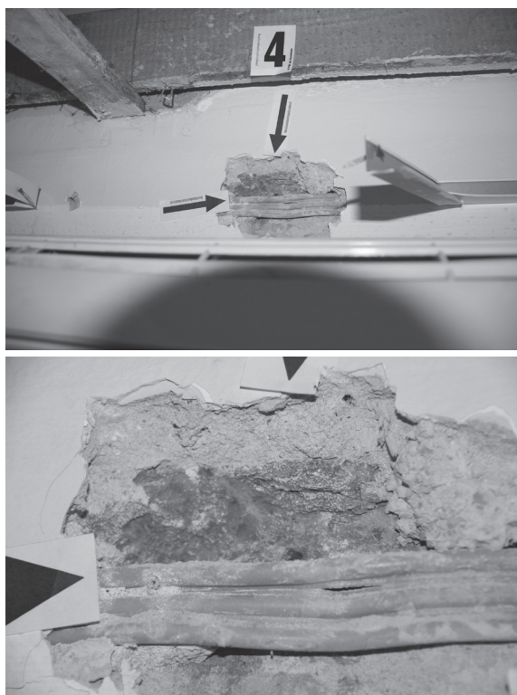
Slika 6. Oštećenje i kvar na električnoj instalaciji
