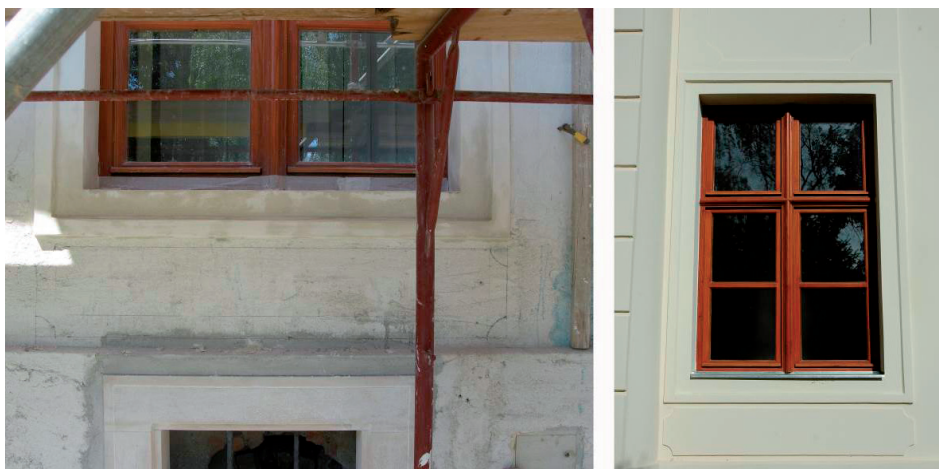
Slika 15 i 16. Olovkom naznačeno mjesto za izvedbu žbukanog medaljona ispod prozora u prizemlju tijekom radova 2017. i prozor s novom stolarijom i izvedenim medaljonom na parapetu, nakon radova 2018. godine
