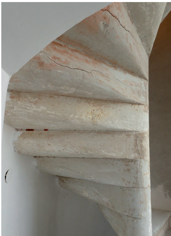
Slika 32. Spiralne stube s vidljivim krakelirama prije radova
