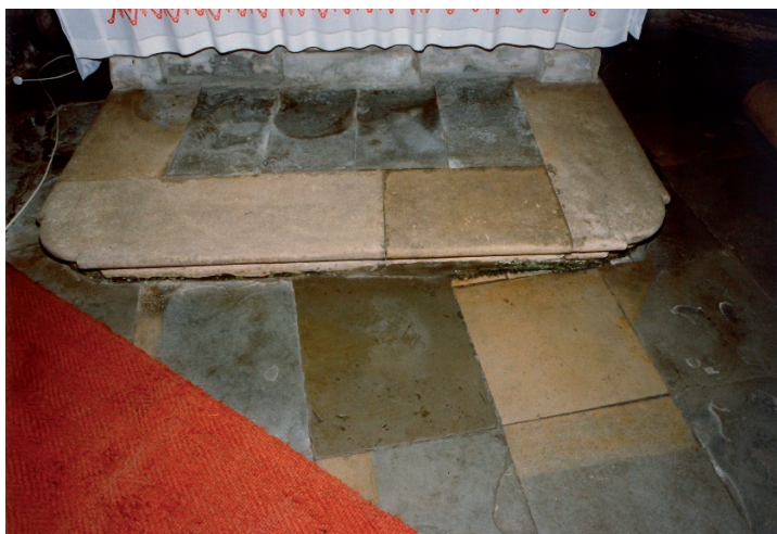
Slika 13. Detalj poda i oltarne stube u lađi, rošenje pojedinih ploča, zatečeno stanje
