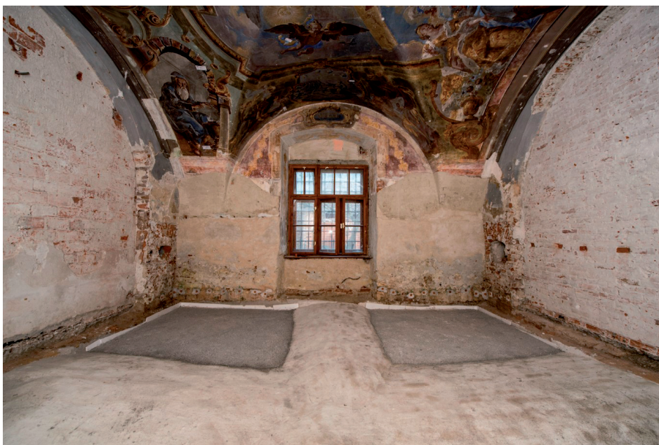
Slika 6. Prostorija ljekarne nakon uklanjanja betonskog poda i mokrog agregata i postavljanja laganog betona, pogled prema sjeveru (fototeka HRZ-a, N. Vasić, 2016.)
