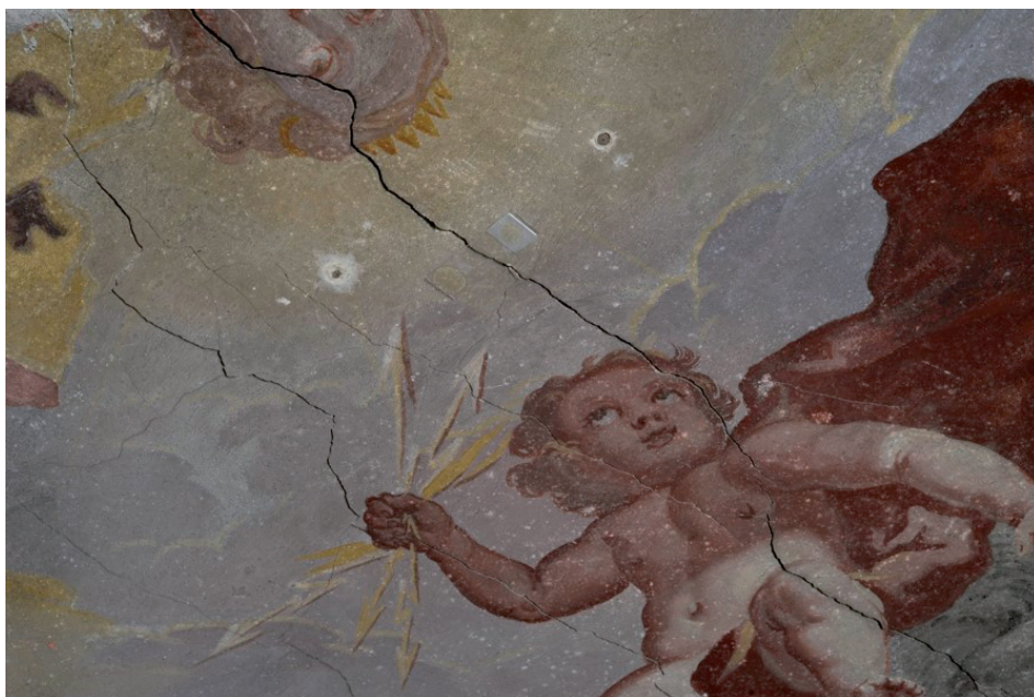
Slika 5. Detalj svodne slike s vidljivim pukotinama i oštećenjima slikanog sloja (fototeka HRZ-a, N. Vasić, 2013.)
