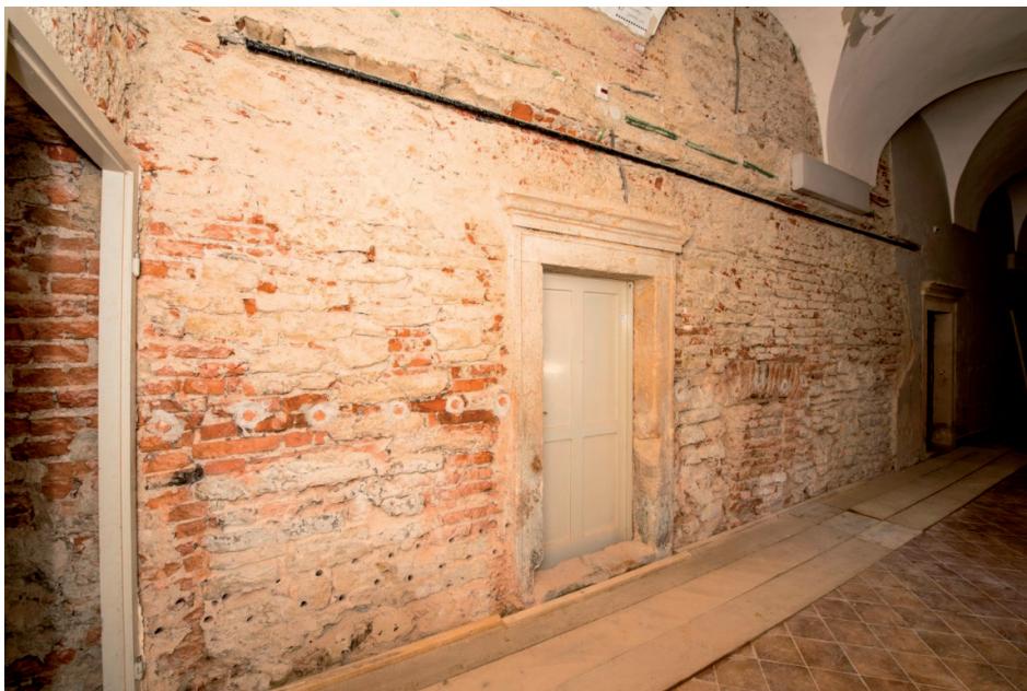
Slika 7. Sjeverni zid hodnika nakon uklanjanja cementne žbuke i akvatril premaza (fototeka HRZ-a, N. Vasić, 2016.)
