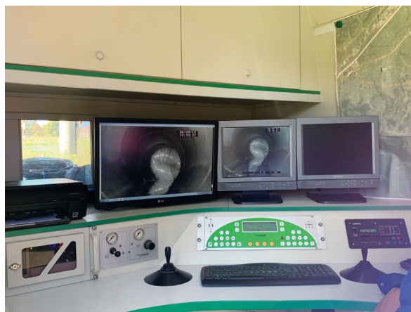
Slika 7: Unutrašnjost vozila za nadzor postupka opremljena je višestrukim monitorima na kojima se prati napredovanje izvrtnja linera
