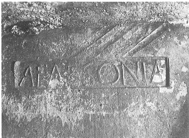
Natpis (žig) AFAESONIA vidljiv na jednoj cigli ugrađenoj u strop tunela ispred kaverne Foto: J. Posarić
