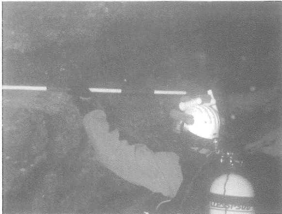
Premjer horizontalne pukotine na 18 m dubine
