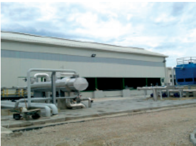
Slika 12. Kompresorska i pumpna stanica sa sustavom za ukapljivanje ugljičnog dioksida u Ivanić-Gradu
