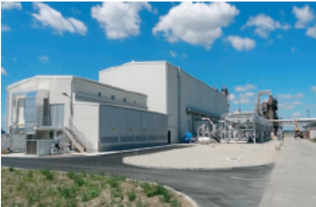
Slika 11. Kompresorska stanica za ugljični dioksid na CPS Molve
