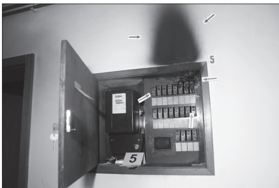
Slika 3. Tragovi udara groma u električnom ormariću
