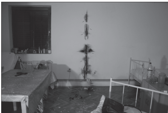
Slika 2. Tragovi udara groma na električnoj instalaciji u objektu
