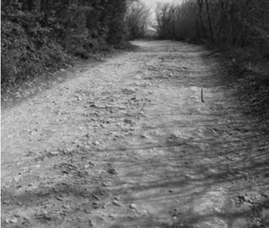
Resti della strada lungo il suo tratto iniziale a partire da Lavarigo
