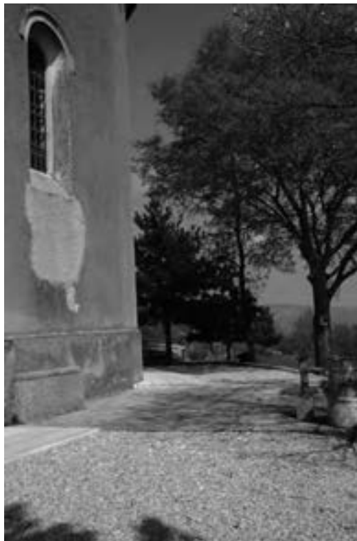
Fig. 6 – 2009: aspetto attuale della cisterna di Santa Caterina (foto C. Pericin)
