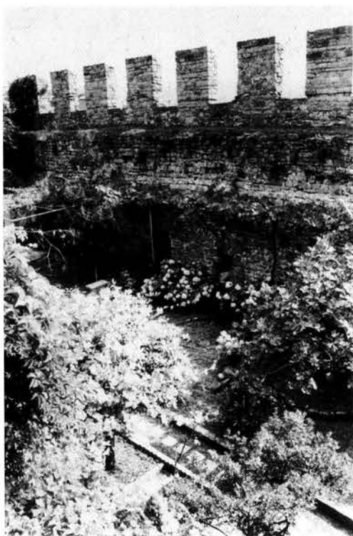
Fig. 10 - Muggia, castello trecentesco del patriarca Marquardo: i camminamenti di ronda lungo il perimetro interno del recinto.
