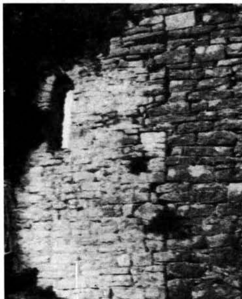
71 - Due Castelli, il complesso della basilica di S. Sofia - struttura muraria del muro di fondo della navata settentrionale.
