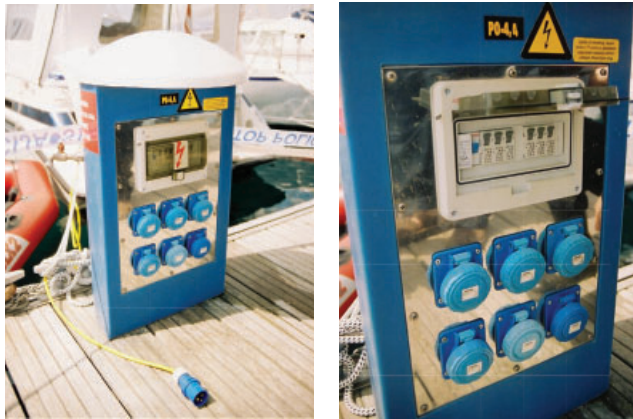
Slika 1. Opći i bliži izgled priključnog ormara u marini Figure 1 General and close view of electrical cabinet in marina Izvor: CFIV „Ivan Vučetić“, fotografije s očevida
