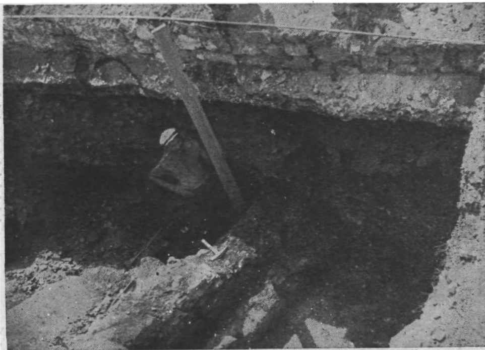
Sl. 100. — Temeljni ostaci rimske zgrade na mjestu mehaničke radionice poduzeća «Nehaj» u Aleji (1956).
