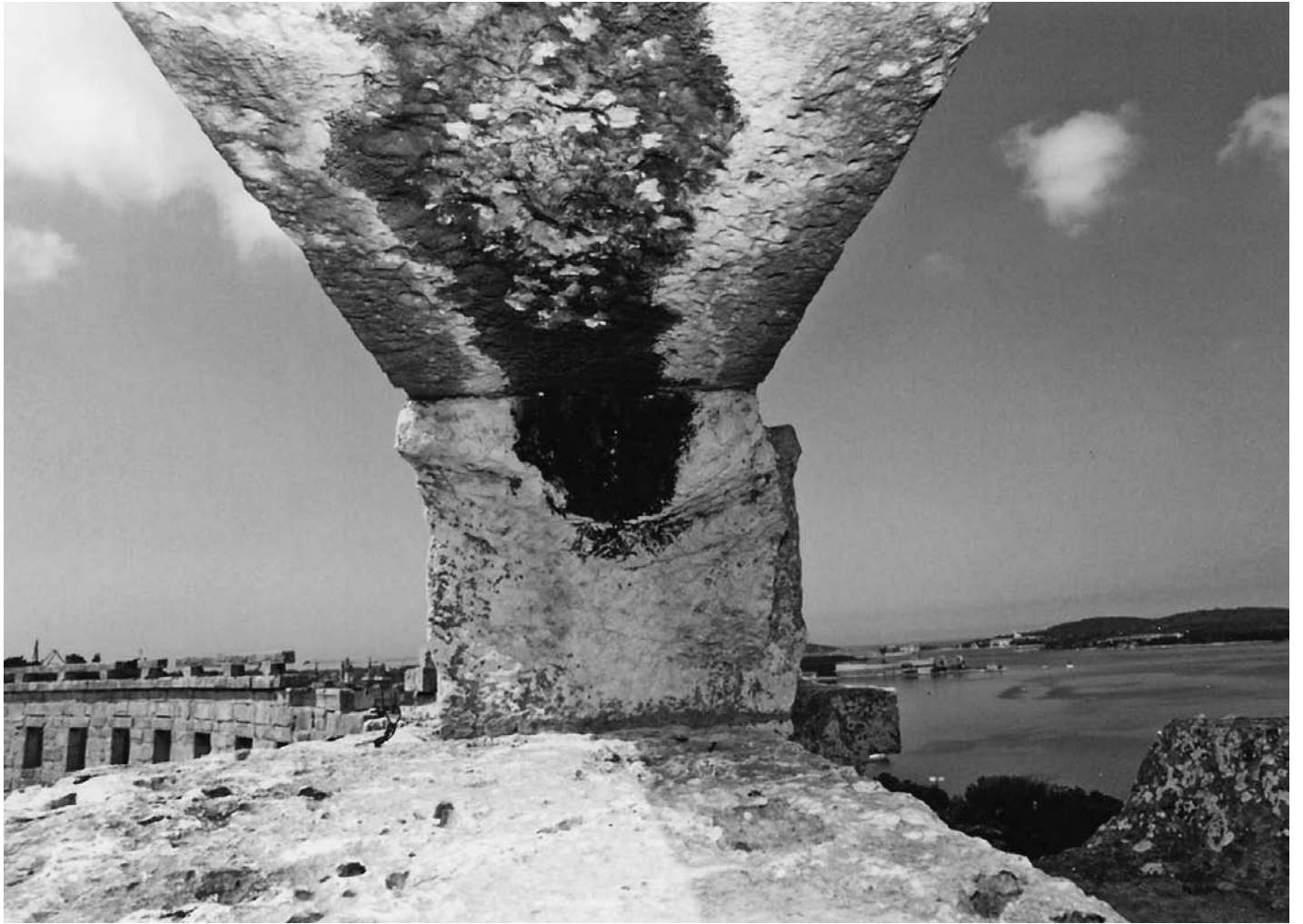
SL. 1. BITVA NA POZ. 32 NA KOJOJ JE BIO PRIVEZAN JEDAN DONJI NOSIVI ZATEZNI ŠTRAJ VELARIJA FIG. 1 BOLLARD ON THE POS. 32 WHERE A LOWER TENSIONING BACKSTAY OF THE VELARIUM IS TIED
