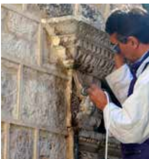
21 Projekt 24: u tijeku čišćenje portala laserom Project 24: laser cleaning of the portal
